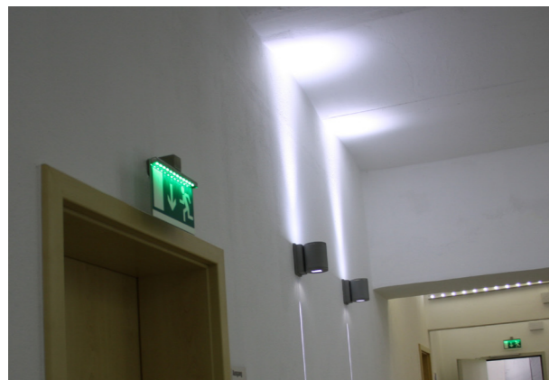
Abb. 3: Beleuchtung von Flurgängen
