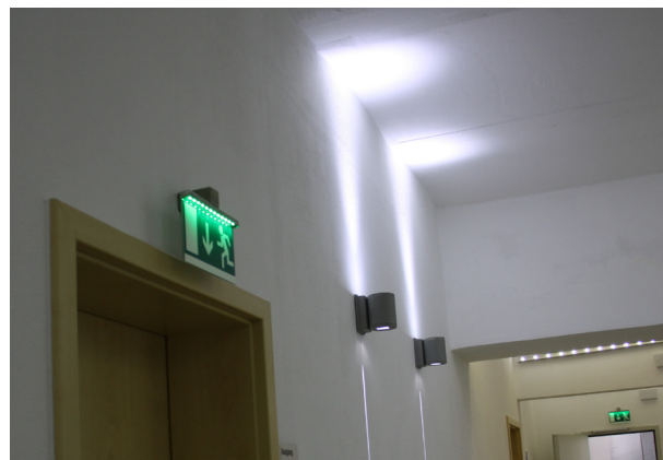
Abb. 3: Beleuchtung von Flurgängen
